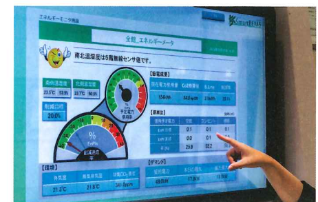
自社ビル1Fに設置されたBEMSのタッチパネル式インターフェース。同社の社員やビル利用者が自由に操作できて、現在のエネルギー消費量をつぶさに知ることができる。
